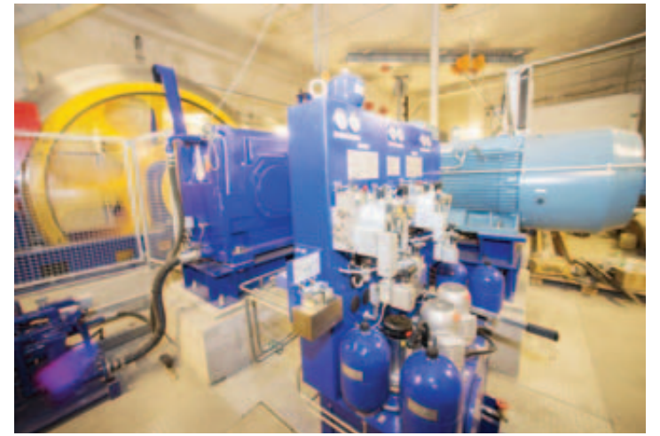
L'imposante salle des machines à la gare d'arrivée de Zinal a impressionné les visiteurs. BITTEL
